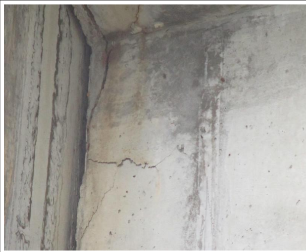
【바닥판 하면 균열/온도변화, 건조수축】
